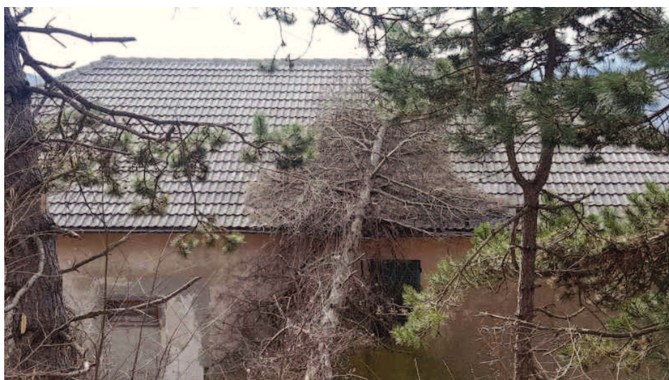
FOTO 2 – RETRO, ALBERO ABBATTUTO SULLA COPERTURA
