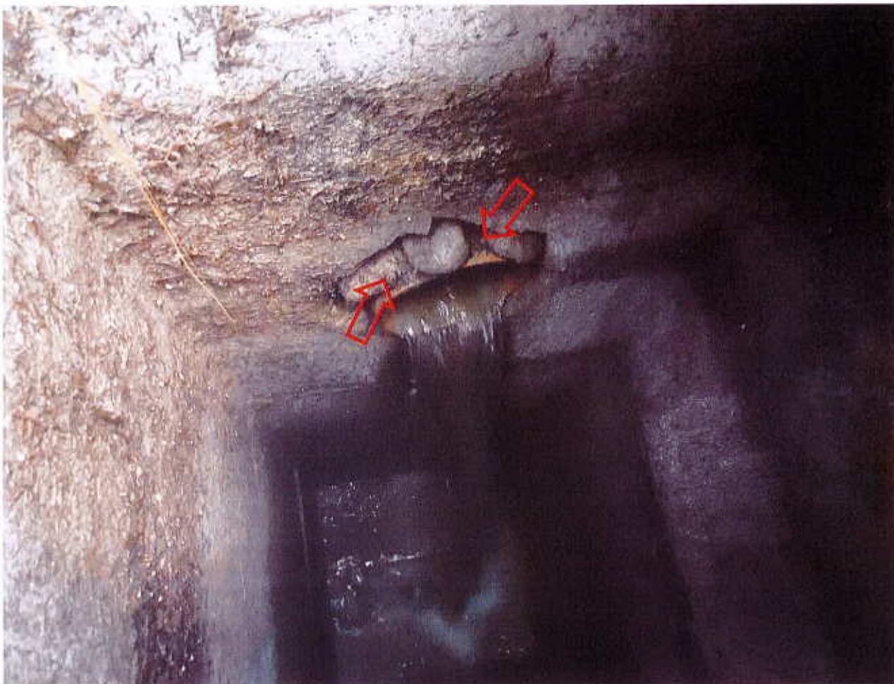
Interno pozzetto di ispezione / allaccio lungo linea fognatura nera
