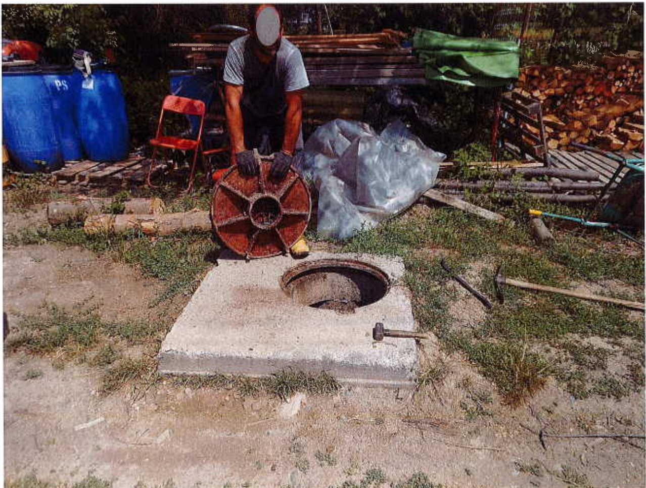
Pozzetto di Ispezione / allaccio lungo linea fognatura nera
