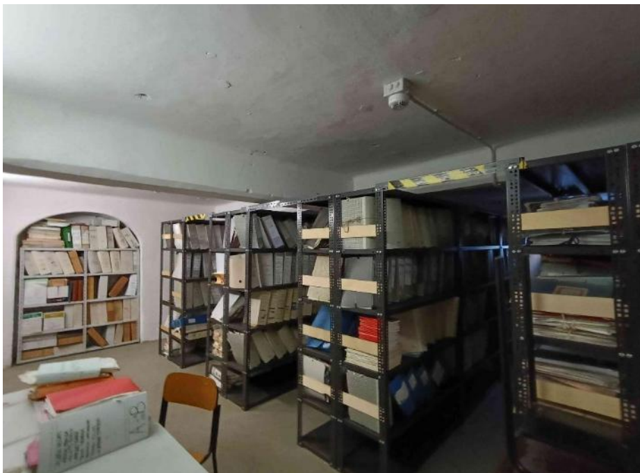
Foto 07 – Rilevatore puntiforme di fumo in essere
