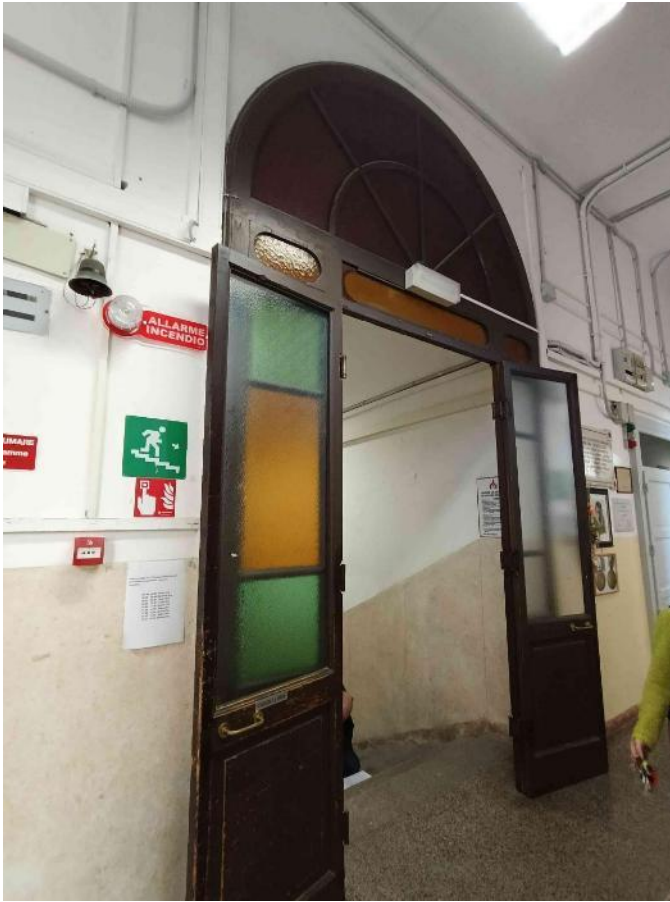
Foto 06 – Pulsante di allarme incendio ed avvisatore ottico-acustico in essere
